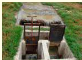
Cámara de rejillas de planta de Tarata. Agosto 2015. No hay personal que limpie las rejillas diariamente, por lo cual el agua residual las rebasa.
