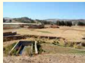
Tanque Imhoff como único tratamiento en la comunidad de Virvini en Tiraque. 2016. No puede existir un tratamiento primario sin tratamiento preliminar.
