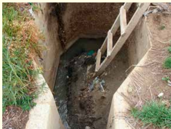
Sedimentador en planta de Tiraque. Agosto 2015. El sedimentador se encuentra 1.5 m debajo del suelo, dificulta el mantenimiento
